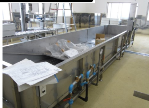
豆腐の冷却水に使用
